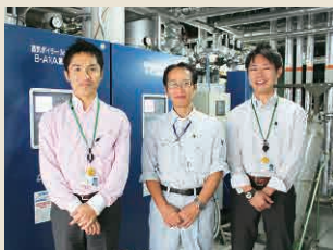
新規に導入した貫流ボイラーの前で
