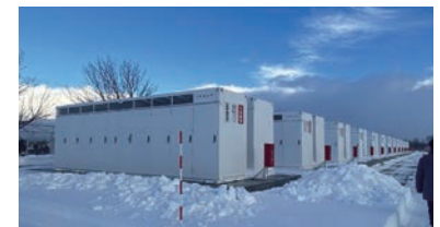
系統用蓄電池事業現地写真(北海道札幌市)
